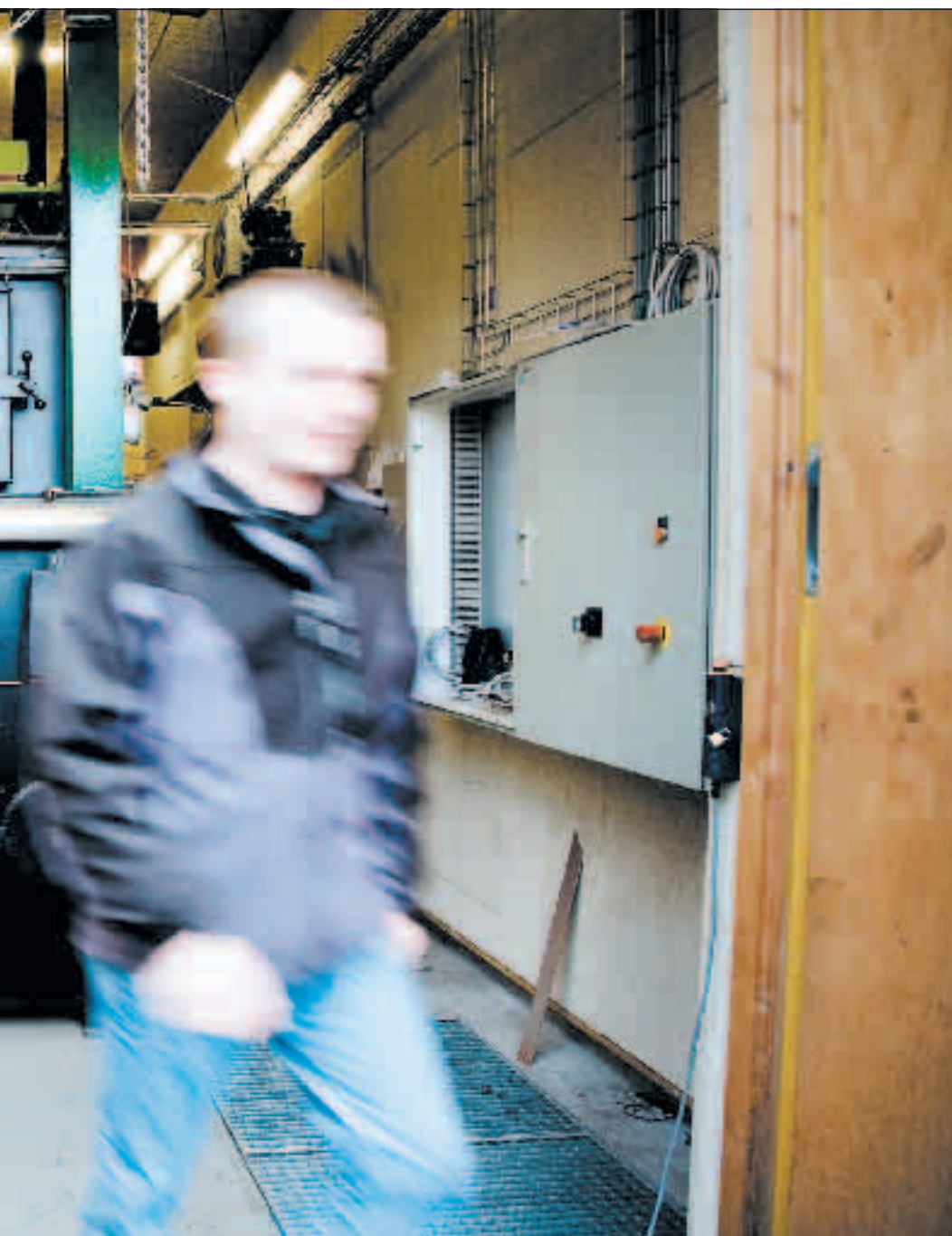
Stirling Danmark er lige nu ved at sætte en motor op i en boligforening ved Århus. Firmaets motorer leverer grøn, CO2-neutral el og varme fra afbrænding af biomasse. Foto: Hans Christian Jacobsen
